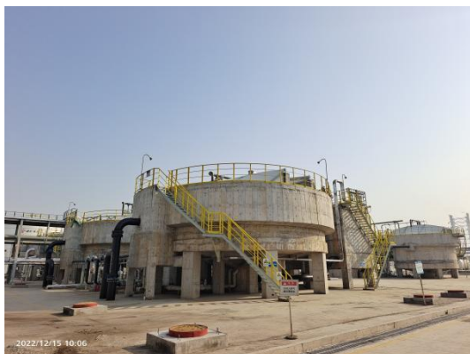
含油污水气浮池
