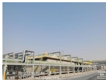
含油污水生化池
